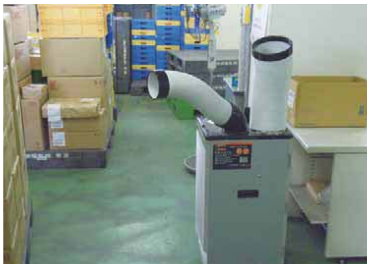
▲ 温熱対策としてスポットクーラーを設置した。
