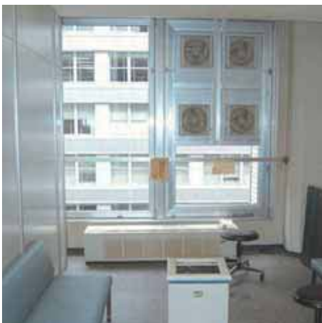
▽ 換気扇を4台設置して十分な排気量を確保した喫煙室
