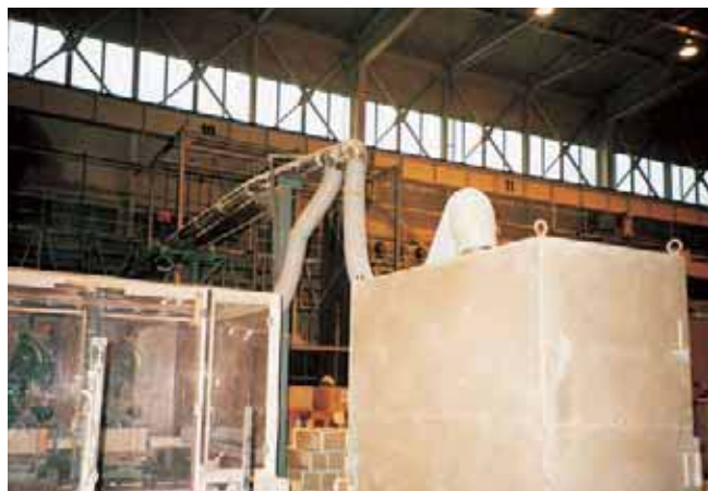
▲ 熱を発する工程を囲い熱気をダクトで外に排出するようにした。
