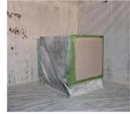
写真VI-3 集じん・排気装置による除じん
