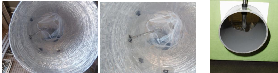
図-30 等速吸引ノズルを使用した場合の排気ダクト内の測定例
