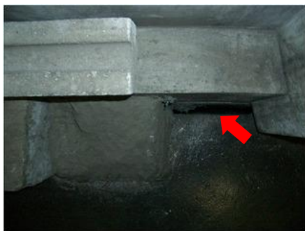
写真Ⅱ-15 スラブ層間塞ぎ充填材なし
