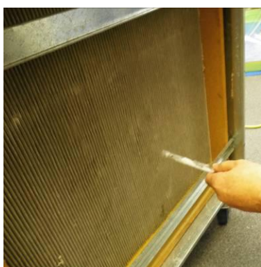
写真Ⅶ-1 HEPA フィルタ面
