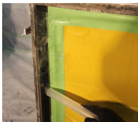
写真Ⅶ-2 HEPA フィルタ周辺部分
