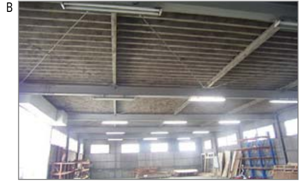
ある工業部品の倉庫の屋根、梁(はり)に石綿が吹きつけられています。倉庫の荷物の出し入れの際に壁を損傷したり、自然劣化等により、石綿が飛散し作業員がばく露する可能性があります。
