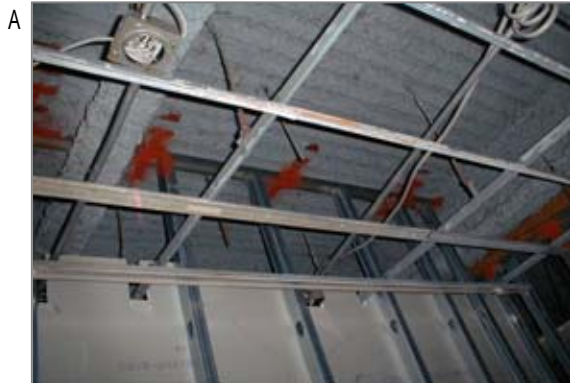
A 吹きつけ石綿のある建物の工事例で電気・衛生・建築業者が作業しました。吹きつけ石綿が除去され赤い鉄骨が見えますが、作業をした際に石綿にばく露した可能性があります。
