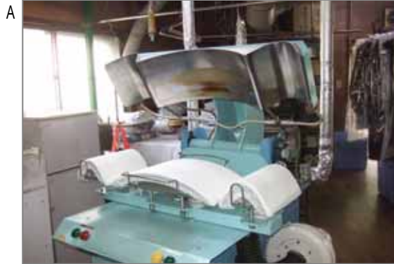
A 町中のクリーニング店のプレス機。軽油などを利用したボイラーは必須です。そのボイラーには保温材が使われています。(この写真には保温材は写っていません)。保温材の劣化によりばく露する可能性があります。
