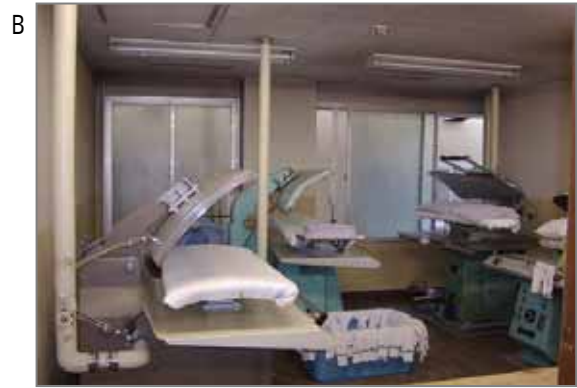
B 大病院のリネン室。すぐ隣に熱源供給のための石綿吹きつけされたボイラー室がありました。吹きつけられた石綿は自然劣化や損傷により繊維が飛散した可能性があり、扉が開け放たれていた場合にはこの部屋にも繊維が飛散してきた可能性も否定できません。
