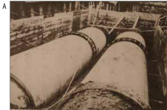
A 青石綿混入の水道用石綿セメント管。工場周辺域での石綿ばく露の可能性が指摘されていますが、取り付け現場でセメント管切断時に石綿粉じんが飛散した可能性もあります。
