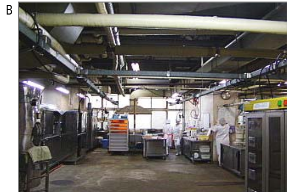
B 大病院の厨房。厨房は火を使う場所ですので、防火や結露防止の目的で石綿の吹きつけがされていることが多いです。こは、天井に石綿が吹きつけられています。
