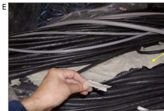
防火や耐火目的で石綿布や石綿板が使用されている場合があります。
