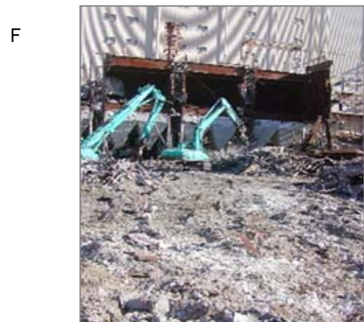
F 多量の石綿製品が使われていた工場などの解体で、重機を使用するのは石綿ばく露の面から大変危険です。保温材が重機で押しつぶされて雪のように白くなって散乱しています。
