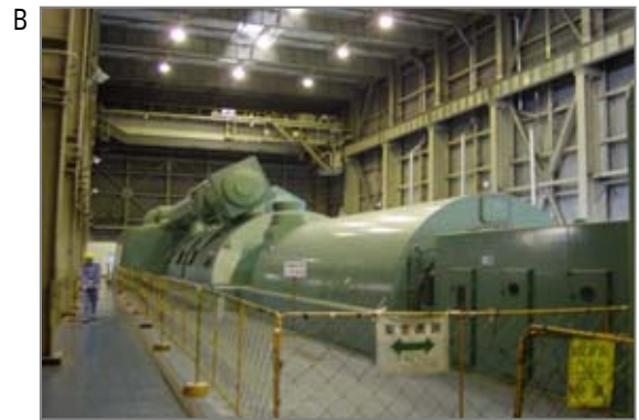
原子力・火力・地熱発電所の配管などに保温材として石綿含有保温材が取り付けられている場合があります。点検・工事時に保温材を取り外すと、石綿が飛散することがあります。
