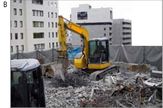
B 屋上に重機を乗せてからのビル解体作業。解体建物の外周部にはその階より高くシートを張ります。建材に石綿が含有している場合には、建材の破碎により現場の作業員が石綿粉じんにはばく露する可能性があります。
