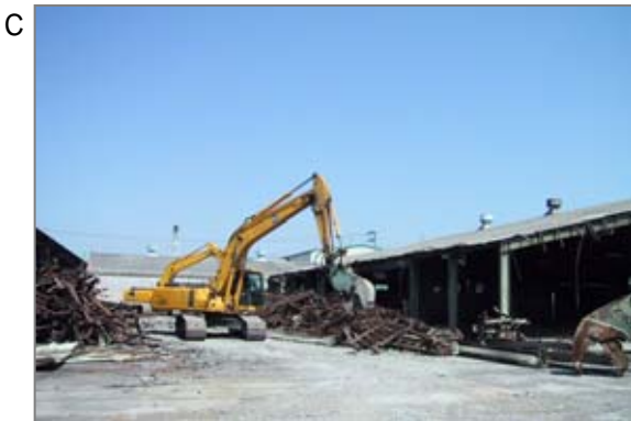
C スレートの屋根・壁のある倉庫の解体作業。粉じんの飛散防止のため、散水しながら作業をする必要があります。
