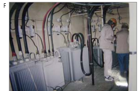
ビルや工場などの建物内の電気設備、配電盤などの部屋の天井や内壁には吹きつけや張りつけの石綿製品が防音のため施工されている場合があります。劣化や破損、修繕等により石綿が飛散することがあります。
