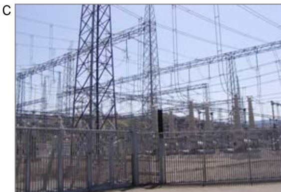
変電所には、耐火を目的とした建材、変電設備の防音材、地中線用の石綿セメント管等に石綿が使用されている場合があります。点検・工事時に防音材等を取り外すと石綿が飛散することがあります。
