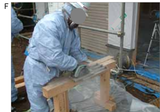
屋根工が、石綿含有の波型スレートを切断する作業です。屋根材、壁材、床材等、建築現場には石綿含有製品が多く、このように現場で切断作業を行うことにより、現場で粉じんが発生します。
