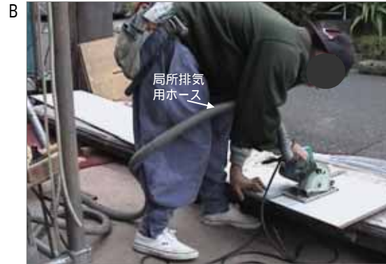
日本家屋の新築で、外壁の石綿含有サイディングを、サイディング工が丸鋸で切断しています。最近の作業で局所排気のホースが見られます。
