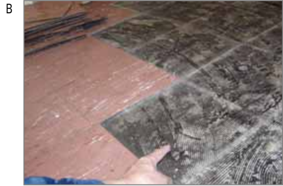
床の石綿含有ビニル床タイルは重歩行度や温湿度、経年などで劣化(剥れ、浮き、磨耗など)します。この黒い接着剤にも石綿は混入しています。張替えはこの接着剤をキレイにサンダー掛しますが、その際に石綿にばく露する可能性があります。
