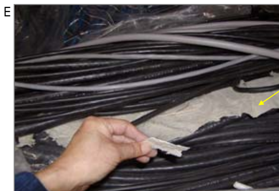
防火や耐火目的で石綿布や石綿板が使用されている場合があります。
