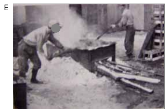
昭和30年代のアスファルト工事(昭和60年頃まで)。アスファルト(石炭副産物・コールタール)の塊をフネ(鉄板の桶)に入れ、下から溶けるまで熱します。アスファルトに石綿を混ぜた時期があったようです。からの順で作業が行われます。
