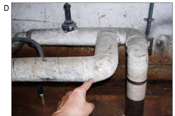
D 配管に石綿含有の水練り保温材を塗布し、包帯状に表面から布を巻き、更に表面塗装しています。劣化・破損がなければ、飛散の可能性はありません。
